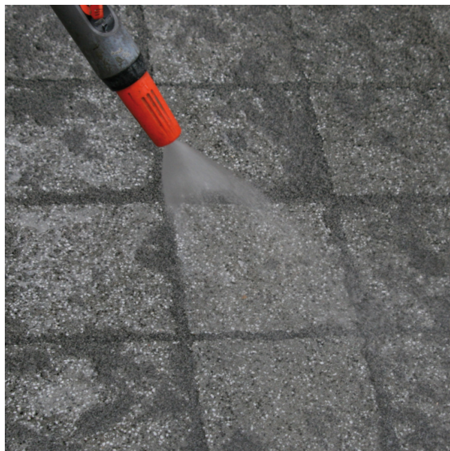
W przypadku spoin od 3 do 8 mm przepłukać powierzchnię lekkim strumieniem wody wzdłuż spoin z jednoczesnym szlamowaniem.
