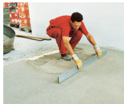
Wykonywanie wysoce odpornego na ścieranie i chemoodpornego jastrychu przemysłowego na bazie PCI Bauharz.
