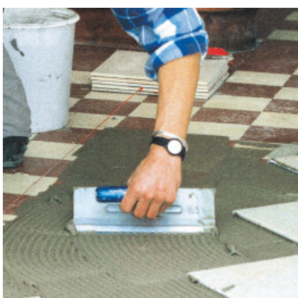
Po ok. 30 - 45 min. można przy użyciu cementowych zapraw klejowych PCI przyklejać nowe okładziny.
