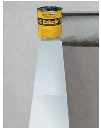
Przyklejona obróbka blacharska
